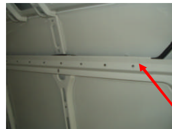
CABLAGES CLOISON CÔTÉ PASSAGER
